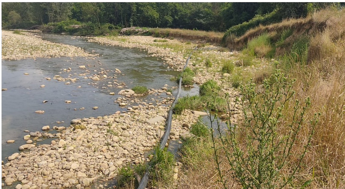
Foto 5(ottobre 2025): Dettaglio della condotta fognaria scalzata dall'erosione.
