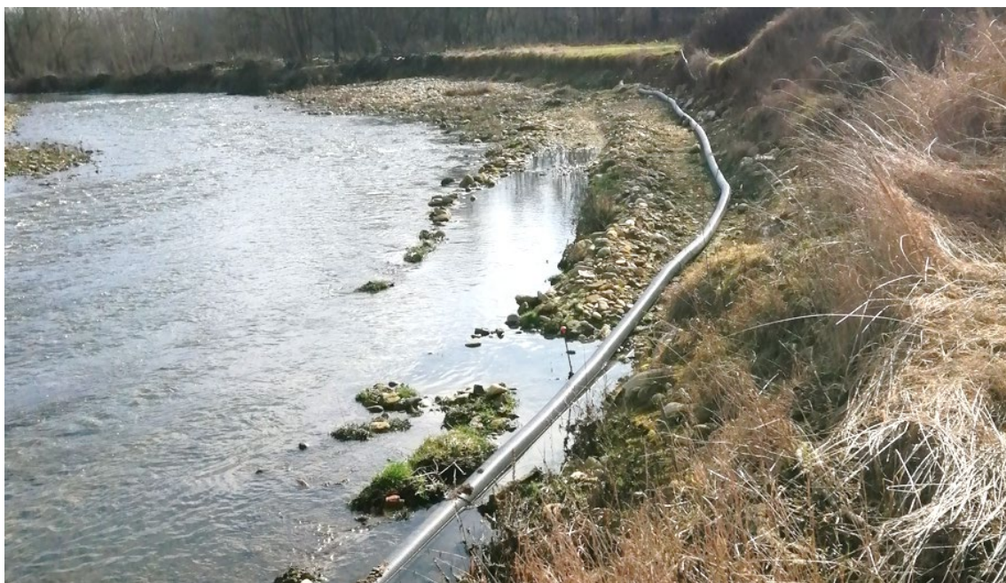
Foto 6 (febbraio 2026): La stessa condotta dopo un intervento preliminare di sistemazione al piede della scarpata.
