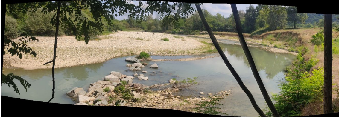
Foto 7 (ottobre 2025): Vista da NO dei resti della scogliera che proteggeva la sponda destra del torrente ed è stata scavalcata ed in parte asportata dalla piena..
